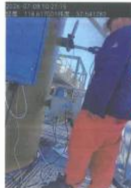
DA019焚烧炉排气筒
