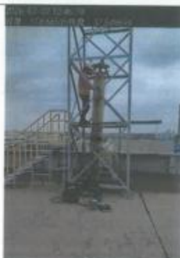
DA009 二车间排气筒
