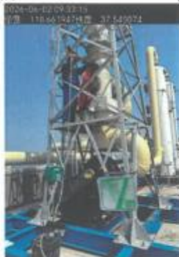
DA013 新戊合成工序甲醇尾气吸收排气筒
