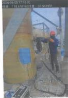
DA019焚烧炉排气筒
