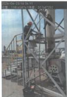
DA009 二车间排气筒
