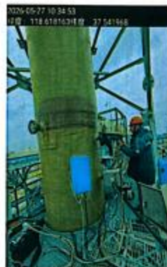
DA019 焚烧炉排气筒
