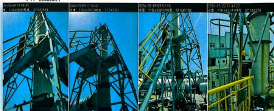
DA004 一车间钠代尾气吸收排气筒 DA005 一车间酰胺尾气吸收排气筒 DA006 一车间唑啉尾气吸收排气筒
