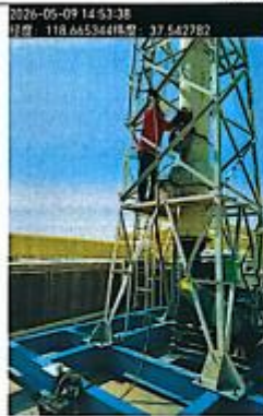
DA013 新戊合成工序甲醇尾气吸收排气筒
