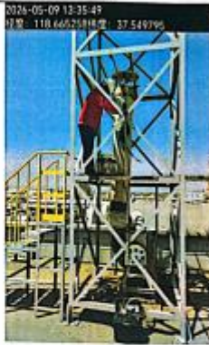
DA009 二车间排气筒
