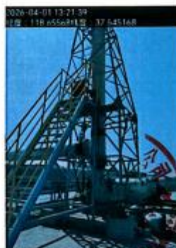
DA005 一车间烯胺尾气吸收排气筒
