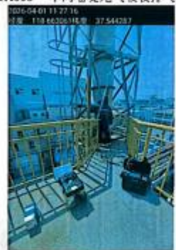
DA007 四车间排气筒
