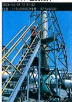
DA006 一车间噻吨尾气吸收排气筒
