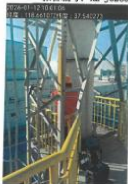
DA007 四车间排气筒
