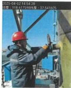
DA019焚烧炉排气筒
