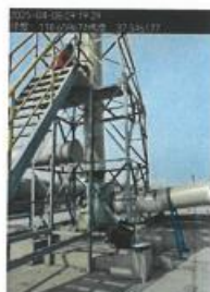
DA005 一车间磺胺尾气吸收排气筒
