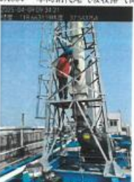
DA013 新戊合成工序甲醇尾气吸收排气筒
