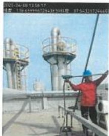
DA003 三车间 1#排气筒
