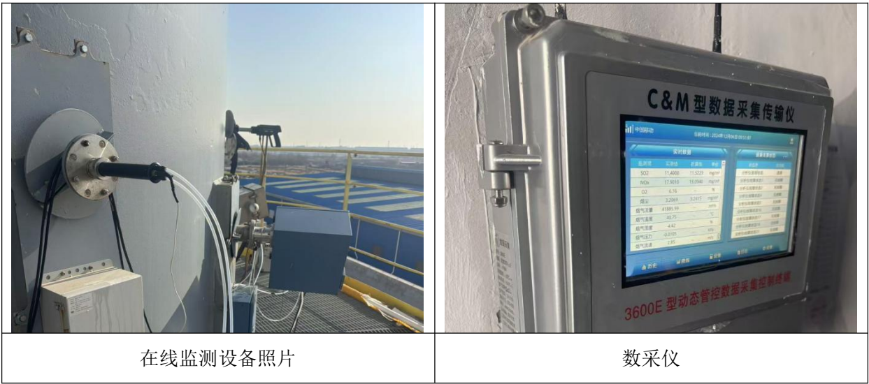
图 4.2-4 锅炉烟气在线监测装置
